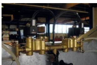
Magnetventile mit Schaltkasten
